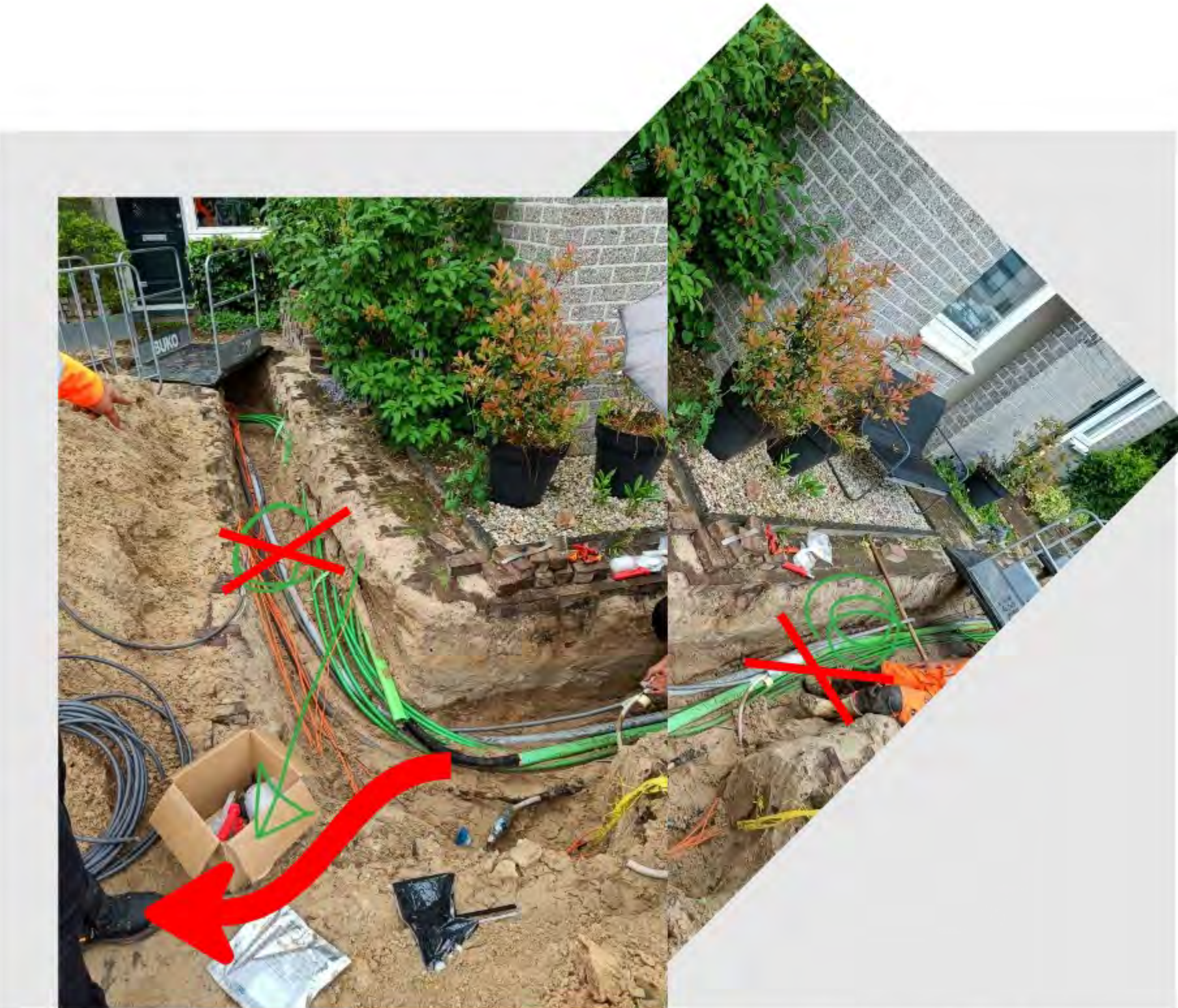
Er zijn plekken waarbij je eventueel de kabel op een ander punt dan de knippunten zou willen herpakken. In het geval op deze foto wordt er vanuit het midden van de kabel getrokken. Hierbij wordt verondersteld dat er aan beide kanten geen module vast zit.
