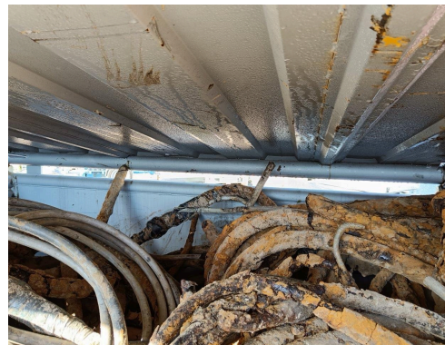
Kabels in beveiligde container
